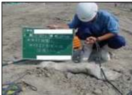
地下水の水位を 監視(測定)
