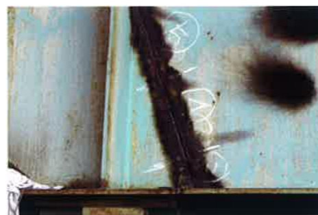
■人為的に与えた亀裂(取壊し予定の橋梁)
